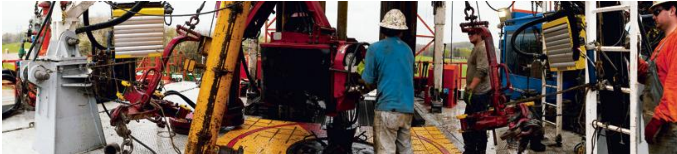
Un site de forage de gaz de schiste en Pennsylvanie, aux Etats-Unis. En France, la zone identifiée par Total, susceptible de renfermer du gaz de schiste, pourrait, selon le groupe, en contenir jusqu'à 2.380 milliards de mètres cubes.
